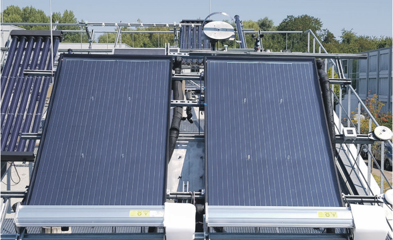
Kollektoren für die solare Energieversorgung von Gebäuden auf dem Dach des Labors für Solare Energiesysteme
