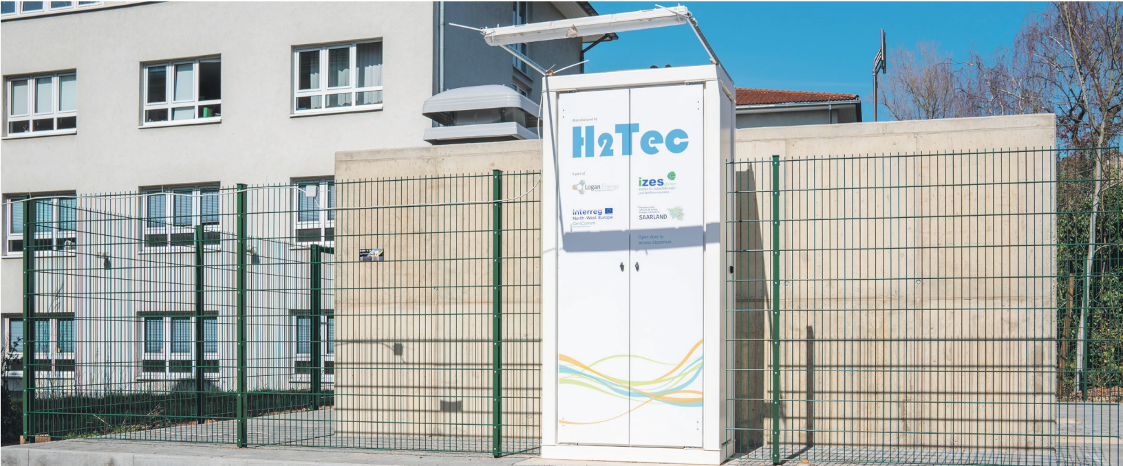
Referenzprojekt „grüne“ Wasserstoffproduktions- und -betankungsanlage am Hochschul-Technologie-Zentrum in Saarbrücken
