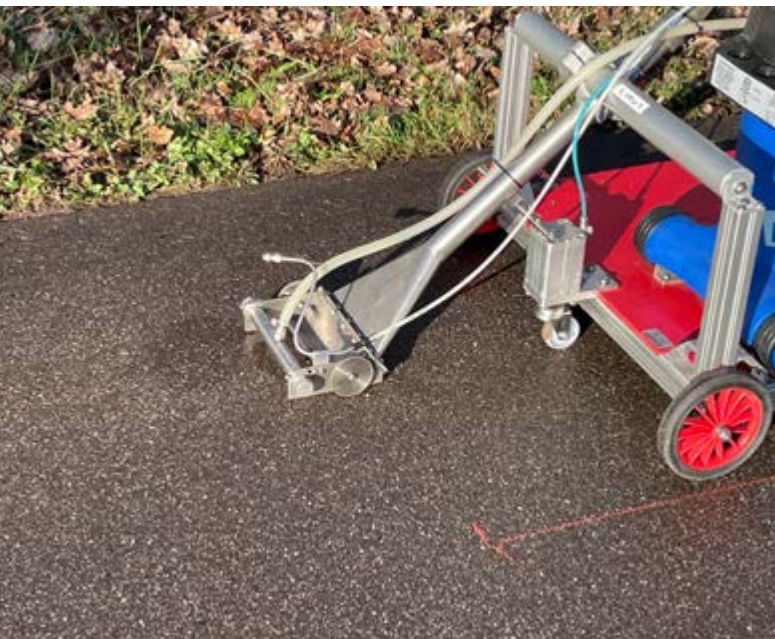
Abb. 5: Spül-Saug-Gerät im Einsatz bei der Messung in Karlsruhe.
