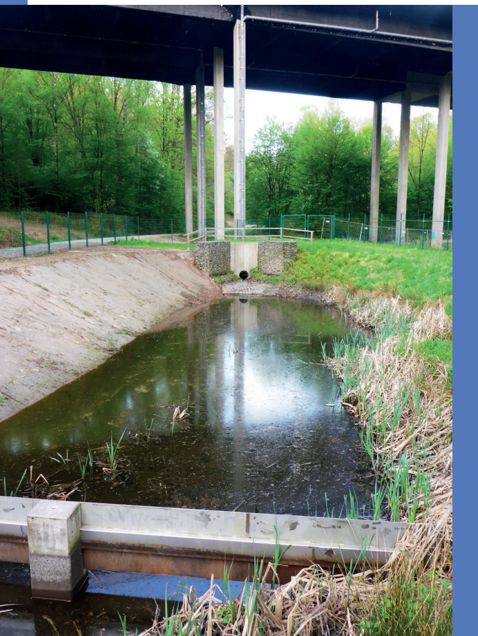
Abb. 1: Leichtflüssigkeitsabscheider der Retentionsbodenfilteranlage Landerthal an der Bundesautobahn A8 mit Blick auf den Zulaufbereich. [2]
