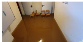
Hochwasser in der Kita Sankt Johannes in Neunkirchen; Quelle: https://www.bistum-trier.de/news/aktuell/news/artikel/Hochwasser-in-Neunkircher-Kita-und-im-momentum/
