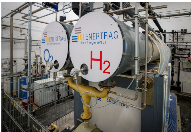
Elektrolyseur des Hybridkraftwerks der ENERTRAG in Prenzlau. © ENERTRAG photo credit Silke Reents
