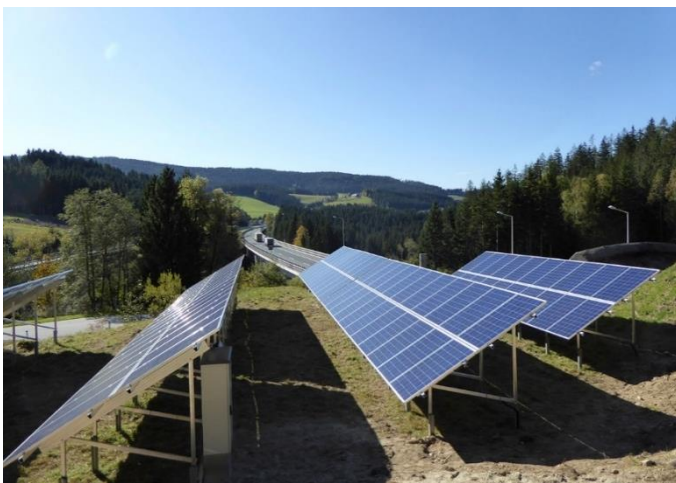
Bild 3: PV-Freiflächenanlage am Herzogbergtunnel, Österreich (Quelle: ASFINAG)
